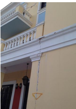
Durch das schwere Erdbeben im Januar 2014 verursachten Schäden in den Fassaden
